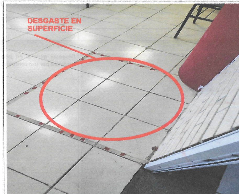
Superficie con fisuras y daños visibles.
