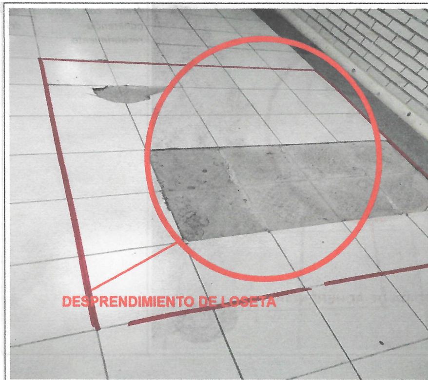
Condiciones generales del piso con afectaciones en distintas zonas.
