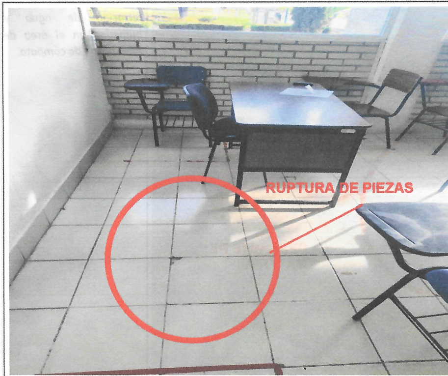
Desprendimiento losetas cerámicas.
