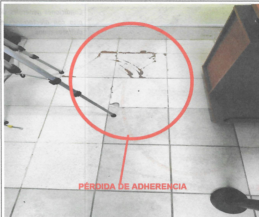
Áreas con pérdida de adherencia del recubrimiento.
